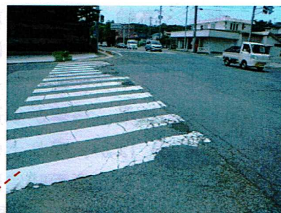
交差点内道路に傷みあり
