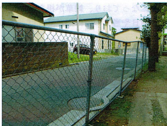
地盤沈下の影響で下がったフェンス
