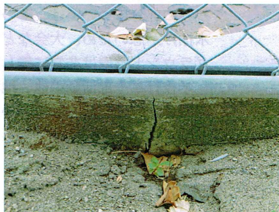
地盤沈下のせいで割れたと思われる
