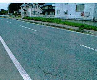
道路にヒビ割れあり
