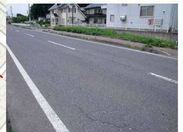
道路にヒビ割れあり
