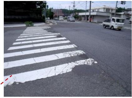
交差点内道路に傷みあり
