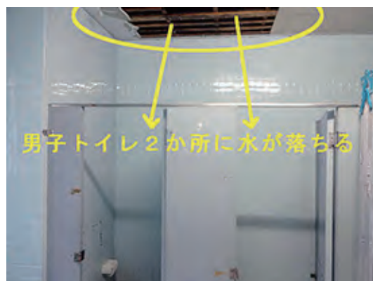
天井の雨漏りで使用禁止にしている
