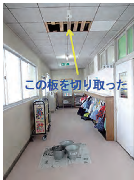
雨漏りがひどく天井をはずし、廊下にはバケツを置いた
