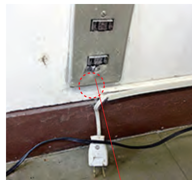
火を出したコンセント
