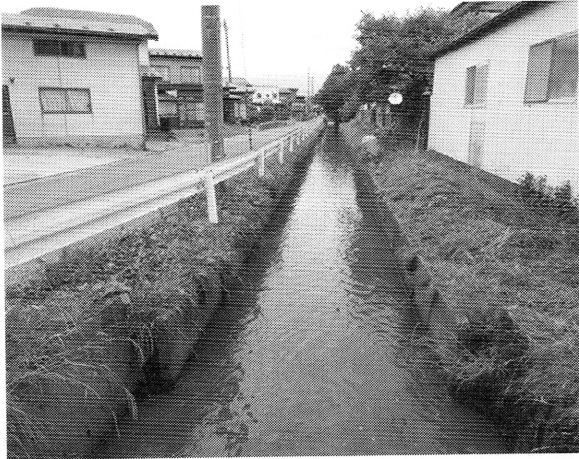
昨年5月18日の大雨警報発令時の排水路の状況。普段は水深10cm程度であるが、当日は60cmを超えた。
