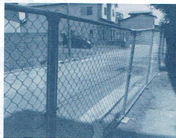
さらに進む地盤沈下
