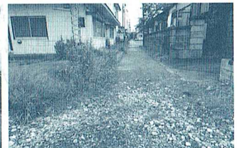
歩道とつながる道路の段差がひどく、大雨時には水たまりができて歩行が困難となる。
