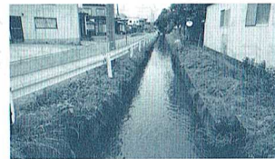
本年5月18日の大雨警報発令時の排水路の状況。首段は水深10cm程度であるが、当日は60cmを超えた。
