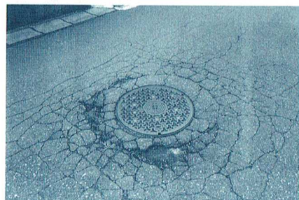
新屋比内町5-19前 ～污水管マンホール周辺のひび割れ
