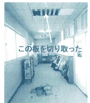
雨漏りがひどく天井をはずし、廊下にはバケツを置いた
