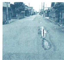
②新屋元町13-7下表町町内会館前 ～改修工事後の凸凹状態
