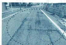
新屋元町5-23～24前～ひび割れ
