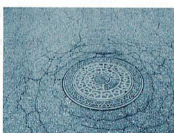
⑭新屋比内町64-2前 ~污水管マンホール周辺のひび割れ
