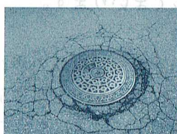
⑨新屋比内町61-3前 ~污水管マンホール周辺のひび割れ
