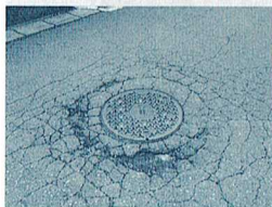
①新屋比内町5-19前 ~污水管マンホール周辺のひび割れ
