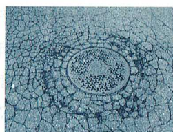
④新屋比内町5-18前 ~污水管マンホール周辺のひび割れ
