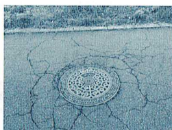
⑦新屋比内町61-2前 ~污水管マンホール周辺のひび割れ
