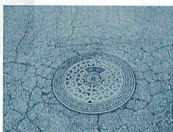
⑫新屋比内町62-14前 ~污水管マンホール周辺のひび割れ
