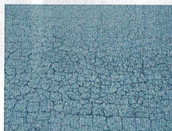
②新屋比内町5-19前 ~アスファルトの亀甲ひび割れ
