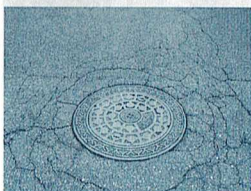
⑪新屋比内町63-13前 ~污水管マンホール周辺のひび割れ
