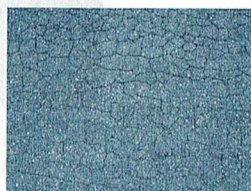
③新屋比内町5-18前 ~アスファルトの亀甲ひび割れ
