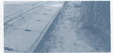
溢れた排水でU字溝の脇の土が削ぎとられている
