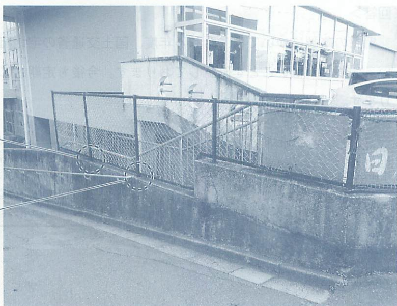
左側の上に支え止めはついているが、支柱が腐蝕して劣化してきている
