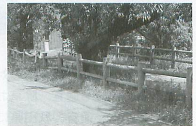
⑱破損したり擬木が曲がっている
