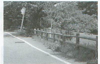
⑫傾いている(電柱も)、修復跡の色が雑
