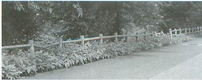
⑧破損したり擬木が外れているほか、傾いてきている
