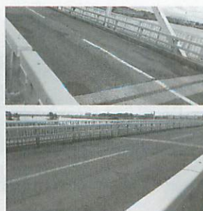
道路の痛みが多い
