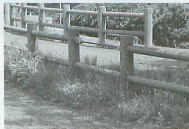
⑰破損している
