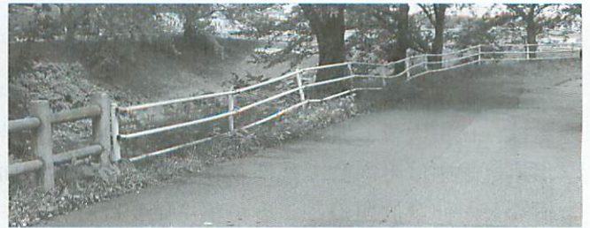
⑨パイプフェンスが曲がったり倒れてきている
