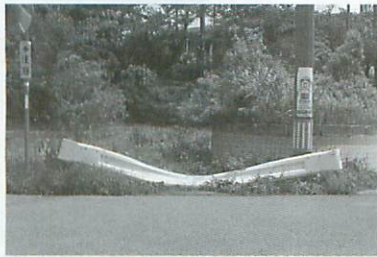
⑩ガードレールが変形している
