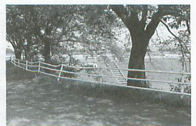
㉔パイプフェンスが曲がったり倒れてきている
