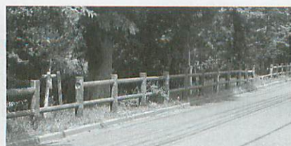
②外れている、破損している
