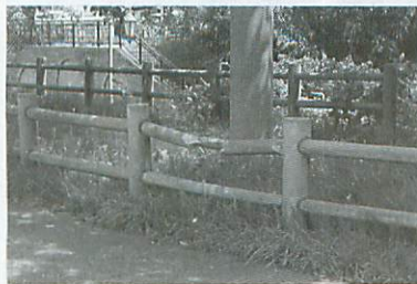
⑯破損している
