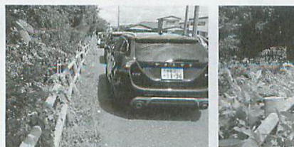
⑤道路が傾き、擬木も傾いている(路上駐車あり)
