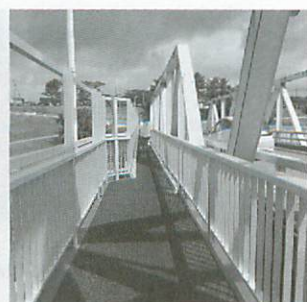
歩道の幅が狭い
