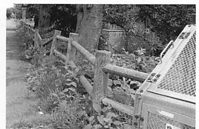
⑳擬木が下がったり、倒れてきている
