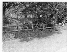
⑧破損したり傾いてきている
