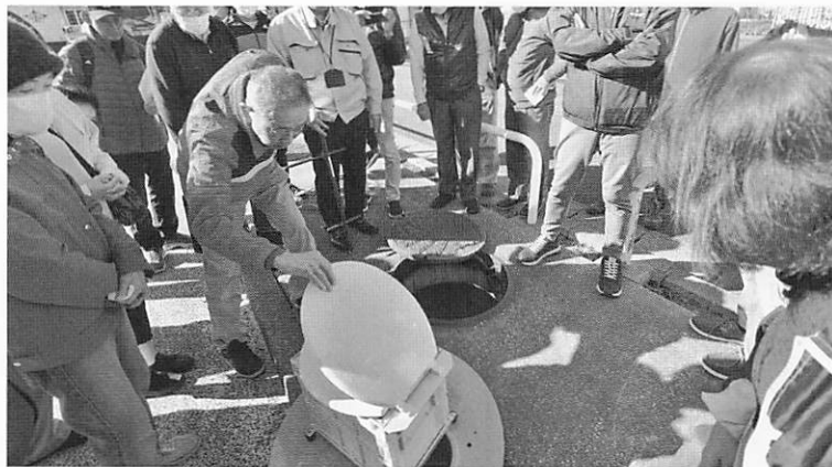
非常用屋外トイレ
