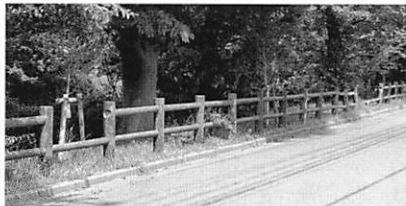
②外れている、破損している
