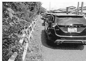
⑤道路が傾き、擬木も傾いている（路上駐車あり）
