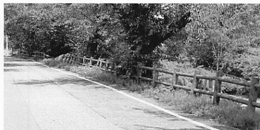
⑮倒れてきている、破損や横の擬木が外れていて危ない
