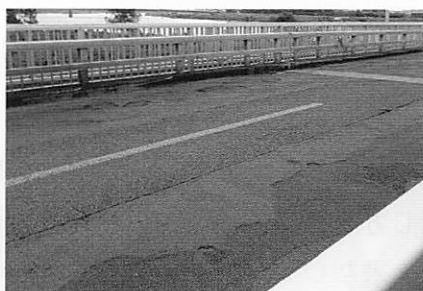
道路の痛み多い
