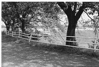
㉒パイプフェンスが曲がったり倒れてきている
