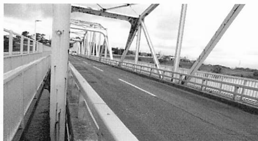
鉄骨の腐食や道路の痛みが進んでいる
