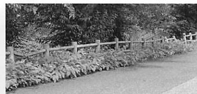
⑦破損したり擬木が外れているほか、傾いてきている
