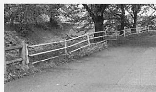
⑩パイプフェンスが曲がったり倒れてきている
