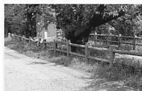
⑳破損したり擬木が曲がっている
