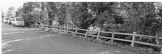
⑥道路が傾き、擬木も傾いている（路上駐車あり）
