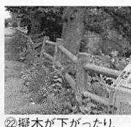
㉒擬木が下がったり、倒れてきている
