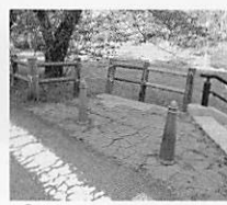
⑫倒れてきている、壊れている
