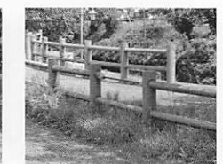
⑲破損している
