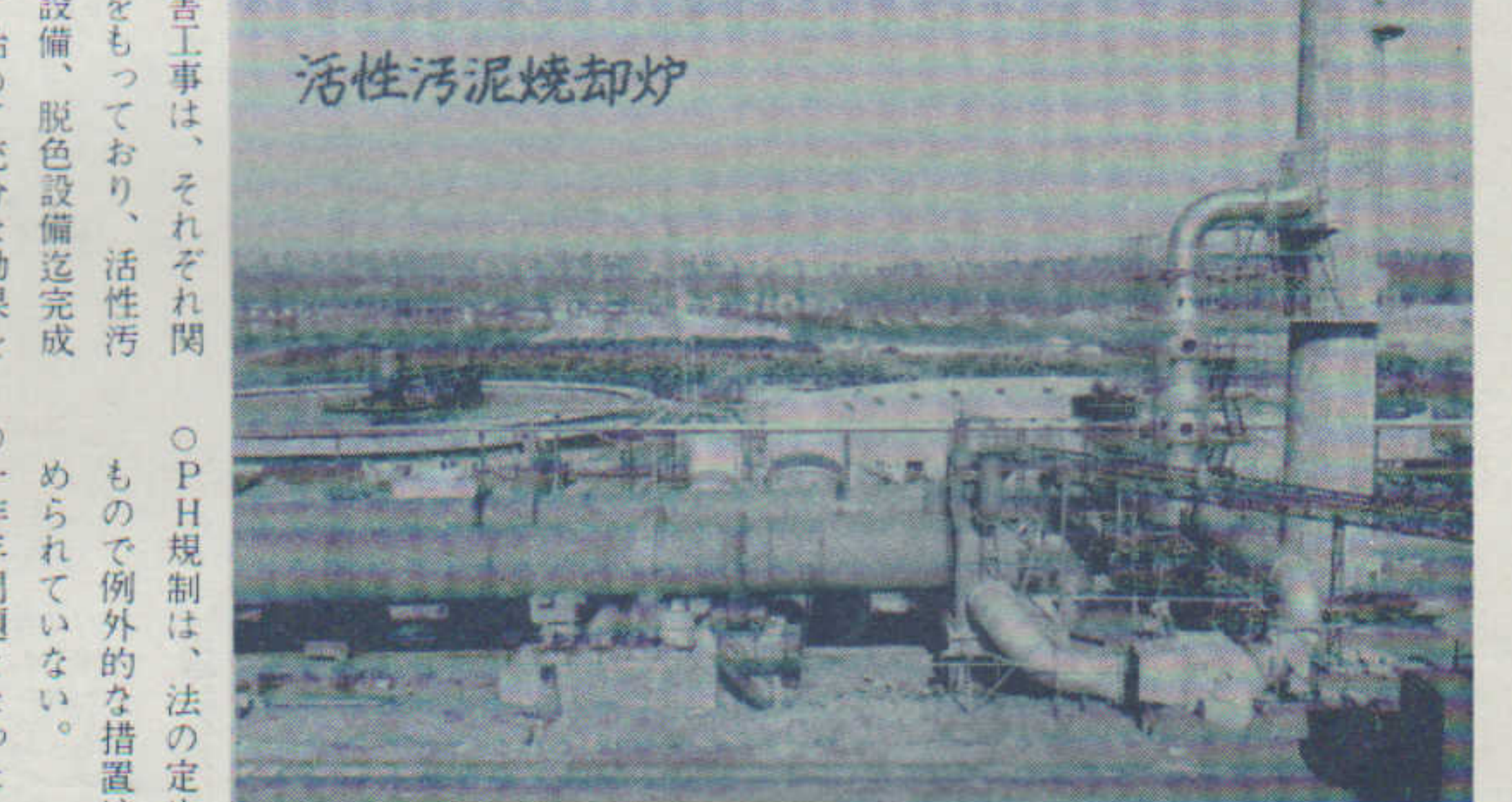
活性汚泥焼却炉
